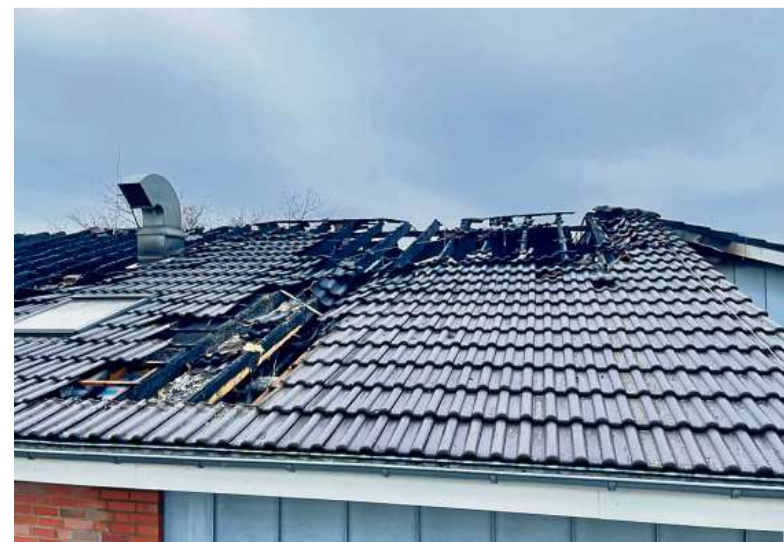
Der Tag danach: Große Teile des Dachs sind zerstört, das Gebäude ist unbewohnbar.
