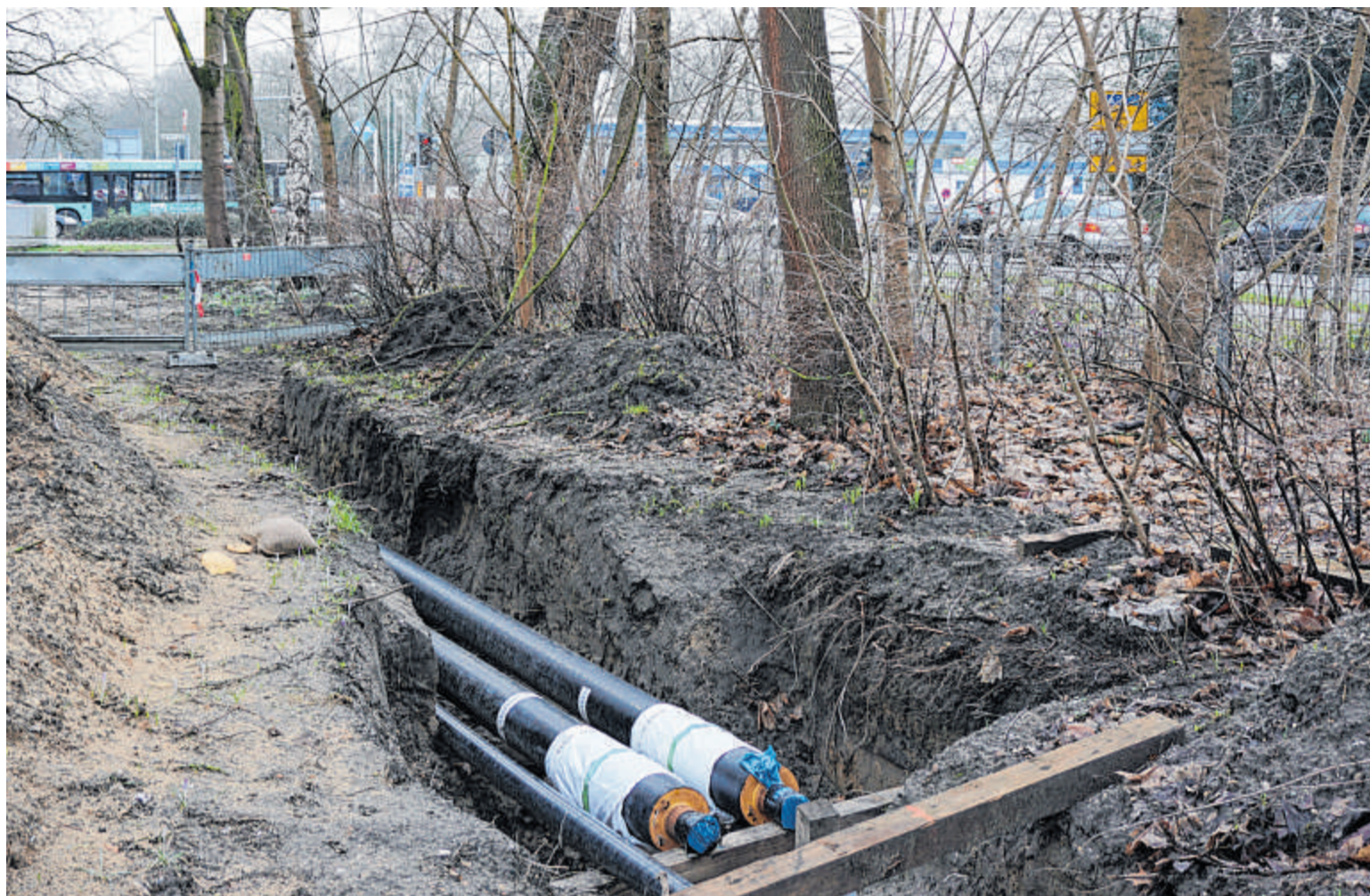
Die Fernwärmeversorgung Niederrhein hat die B 8 in Friedrichsfeld in Richtung Osten gequert.
